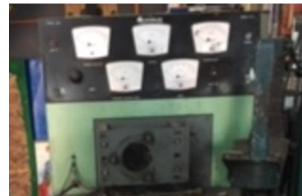
Prueba M. Arranques
